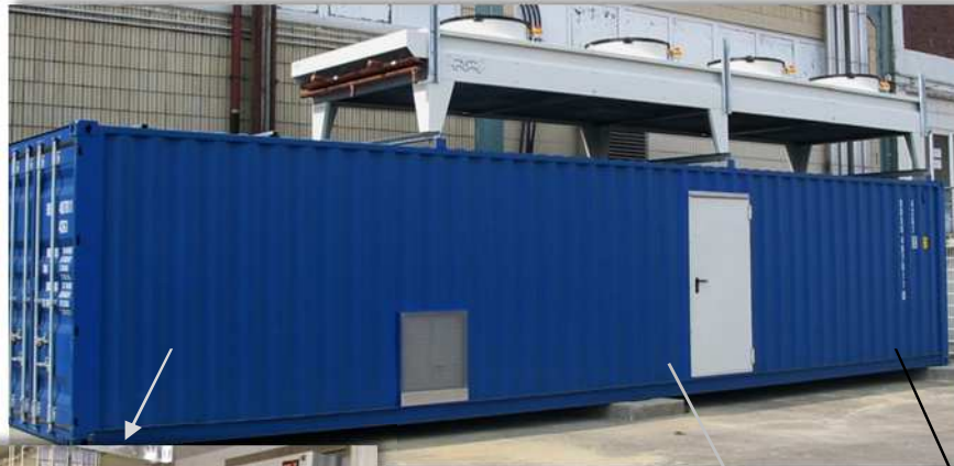
Im 40'-Container integrierte R404A-Verbundkälteanlage
