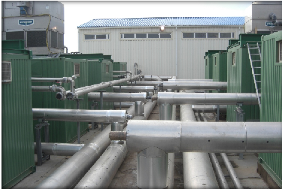
Vor-Ort Soleverrohrung außerhalb der Kältecontainer
