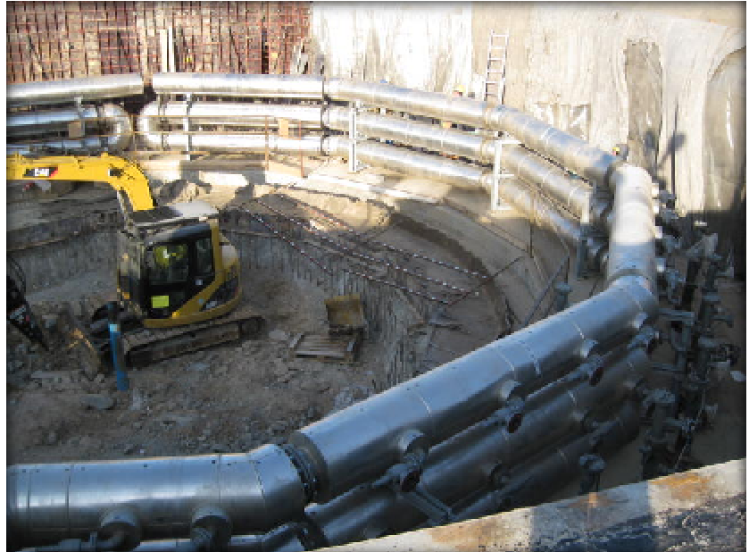
Gefrierrohring in Rußland zur Versorgung der 44 Gefrieranlagen mit Tyfoxit F50® (-38°C)
