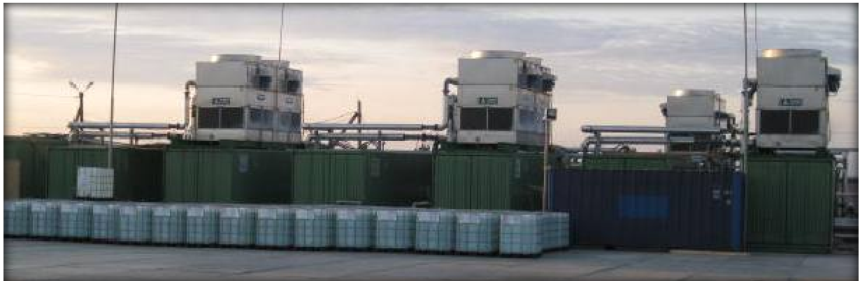
Kältecontainer mit luftgekühlten NH 3 -Verflüssigern mit davorstehenden Solebehältern
