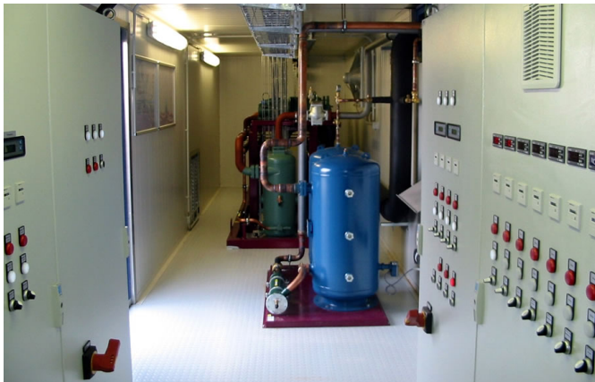
Luftgekühlte R404A Verbundkälteanlage
