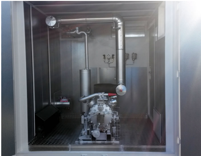
Blick auf den Verdichter im Container
